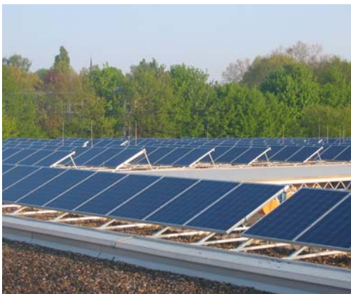
Abbildung: Photovoltaikanlage Rohräckerschule Esslingen 2008
